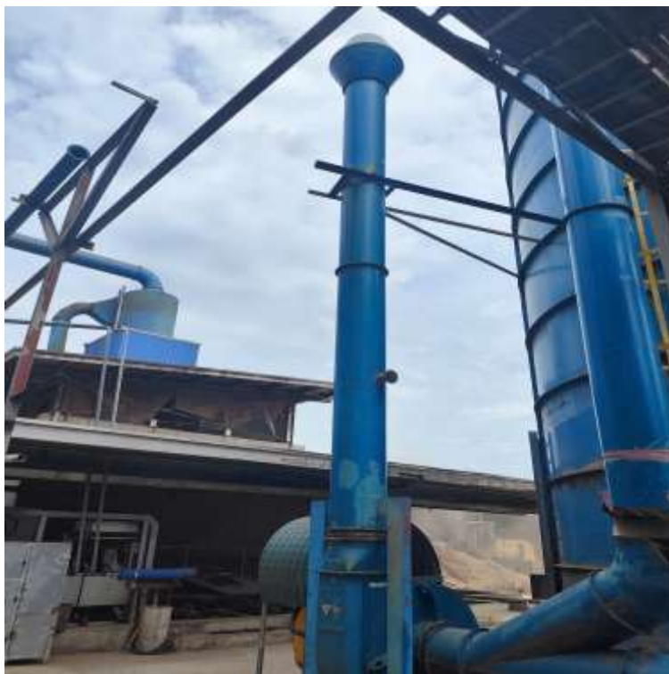
Hình 21. Ống thoát khí khu vực cửa chéo và bụi giữ (K3)
