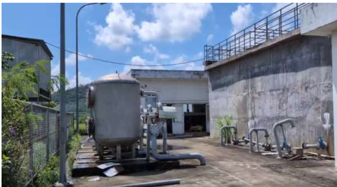
Hình 10. Trạm xử lý nước cấp công suất 350m 3 /ngày đêm
