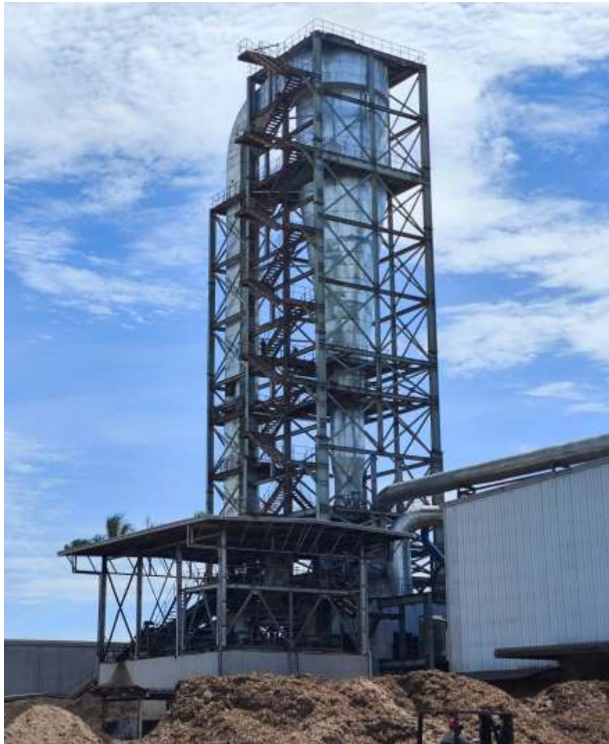
Hình 20. Hệ thống xử lý bụi sau ống sấy sợi K1
