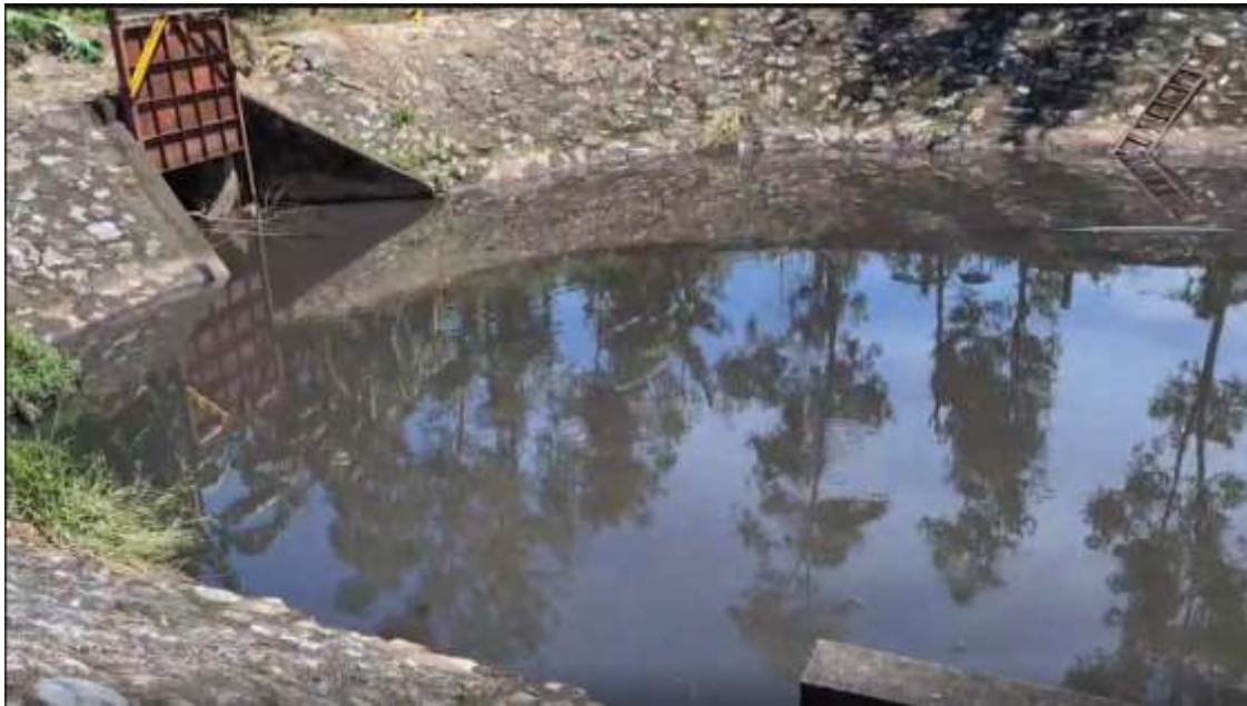
Hình 16. Hồ chứa 350m 3 của Nhà máy
